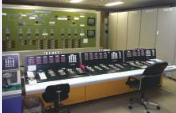
現在の中央監視設備
